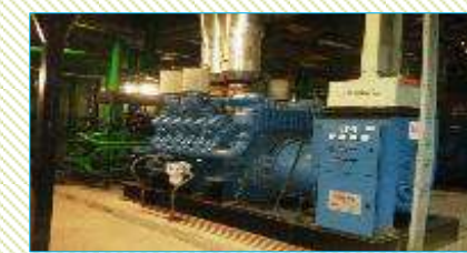
1500KVA DG Set
